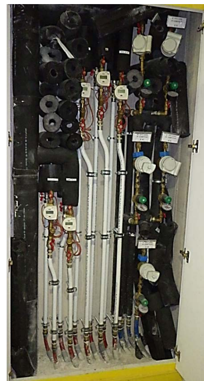
Armoire Technique GT palière, avant la pose des RenoToob
